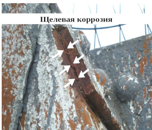
Рисунок 1 – Щелевая коррозия металлов
