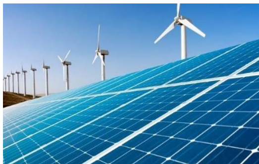
Рисунок 1 – Установка солнечных панелей для применения солнечной энергии
