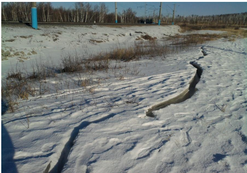
Рисунок 2 – Бугры наледи перед мостом и вдоль земляного полотна дороги
